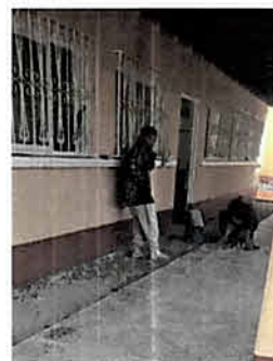
Foto 4: Sustitución de piso con salitre
